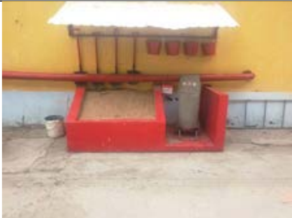
装置区消防沙池
