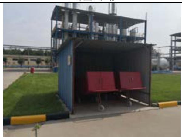
厂区消防设施
