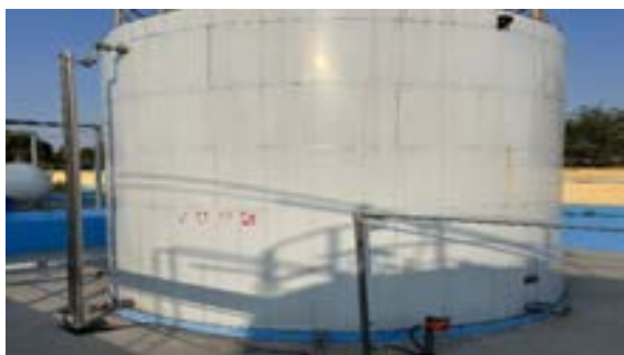
胶乳储罐 (2#罐区)
