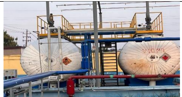
胶乳储罐 (1#罐区)
