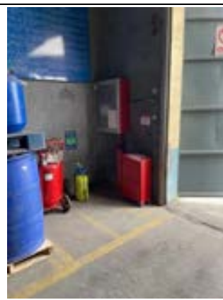
仓库区灭火器
