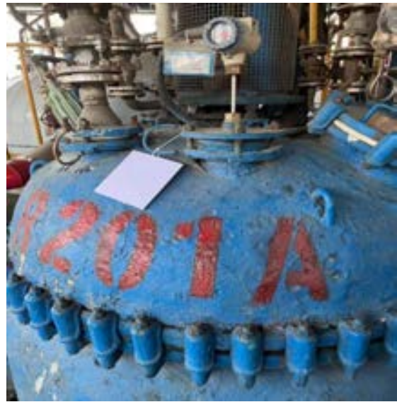
静置分水釜/乳液配料釜
