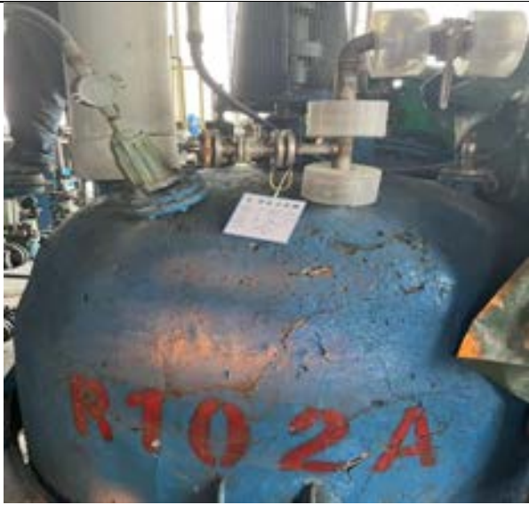
中和釜/丁腈胶乳配料热水罐
